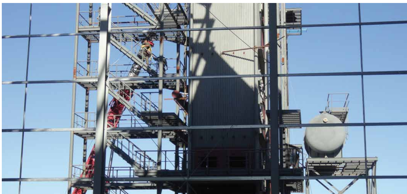
Vista de la caldera. Esta caldera producirá 40 toneladas de vapor por hora a 65 bar de presión y 480°C. Foto: gentileza CAPP.
