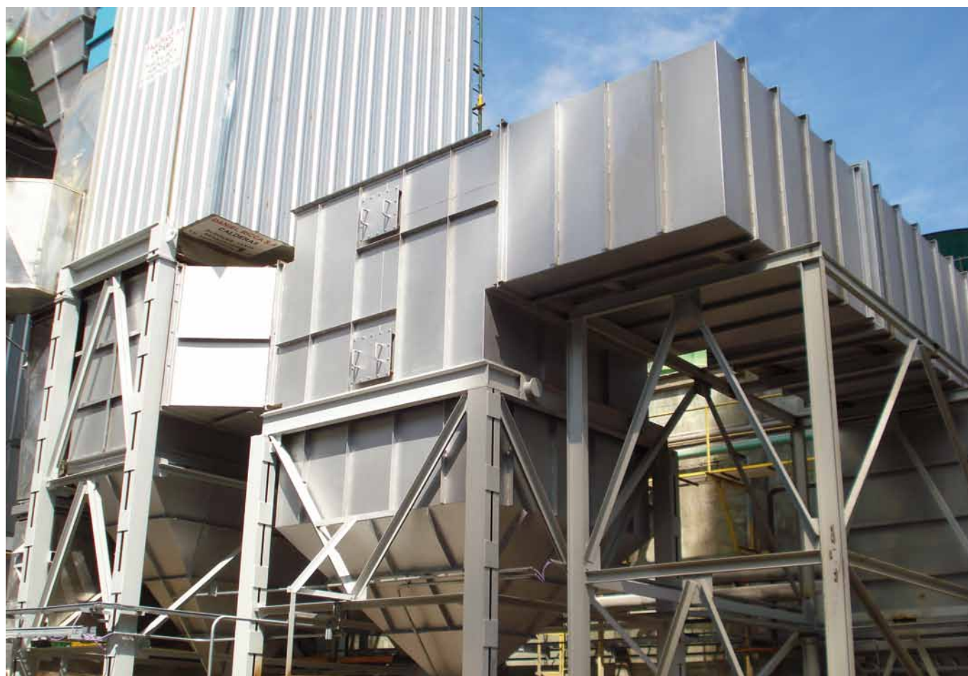
Calentador de aire y precipitador. Equipos auxiliares para calentamiento del aire y purificación de los gases de combustión. Foto: gentileza CAPP.
