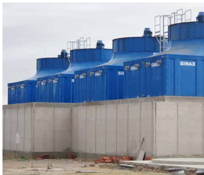
Torres de enfriamiento con capacidad para 2000 metros cúbicos por hora de agua originados del condensador. Foto: gentileza CAPP.
