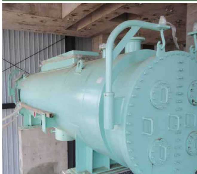
Condensador. Recibe el vapor de salida de la turbina y lo condensa para que el agua retorne a proceso. Foto: gentileza CAPP.
